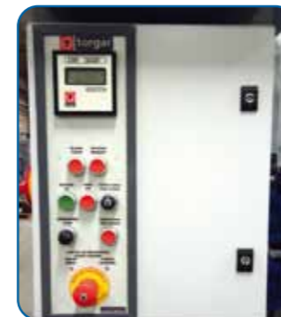
Cuadro de control en base Control panel in the base
