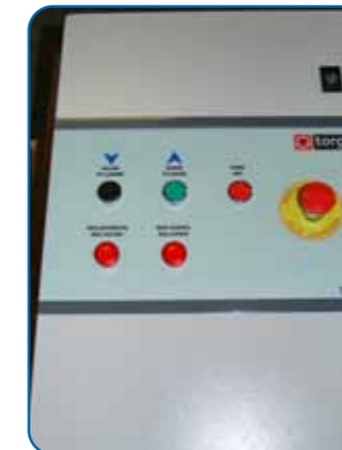
Cuadro de control exterior External control Panel
