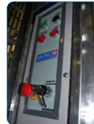
Cuadro eléctrico interior Internal control panel
