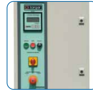
Cuadro de control Control panel
